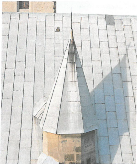
Pokrycie z blachy cynkowej na wieżyczce – widoczne ślady korozji
